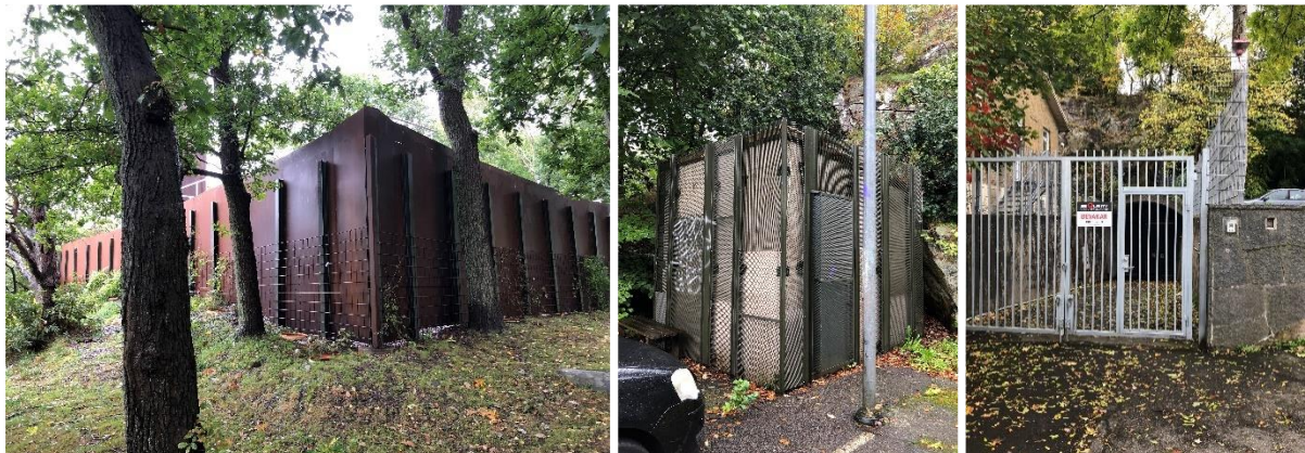
Ovan: Fläktanläggning i Åbybergsparken, utrymningsväg, nedfart till berggrummet.
