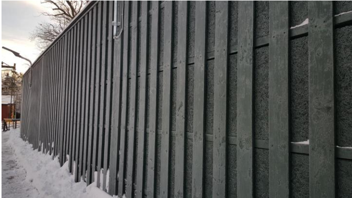
Figur 27. Absorberande bullerskärm i Neglinge station i Nacka. Källa: WSP
